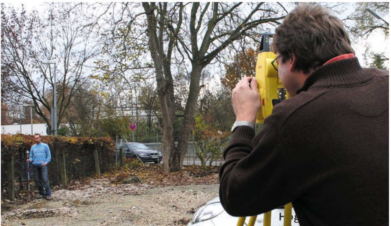
Markus Högl beim Aufmaß mit dem Leica Builder. Die digitalen Geländedaten werden anschließend an das CAD-System VectorWorks übergeben.
